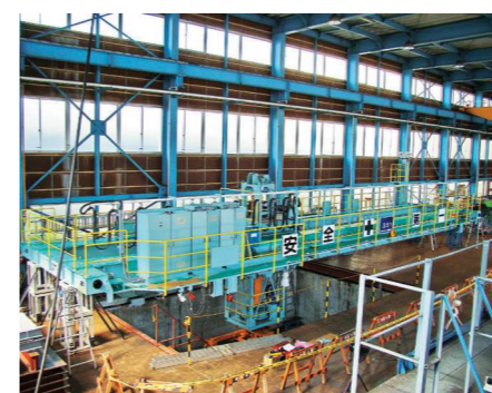
電車台車枠用クラブトロリー式 天井クレーン(10t、スパン20m)
